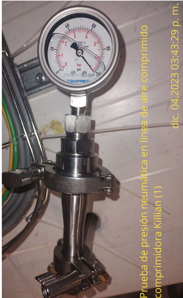
Presión al Inicio de la Prueba en Compresora Killian N°1.
